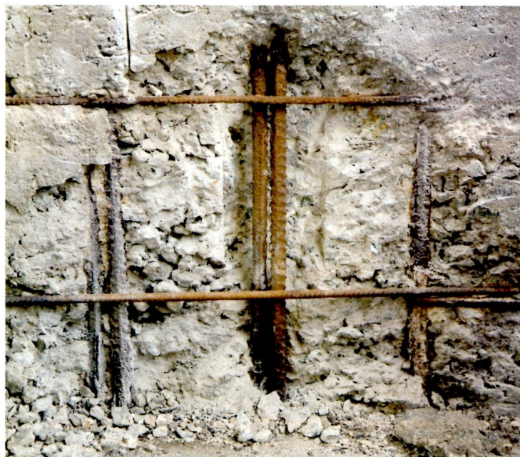
Armadura exposta ainda é um dos principais problemas patológicos da estrutura
